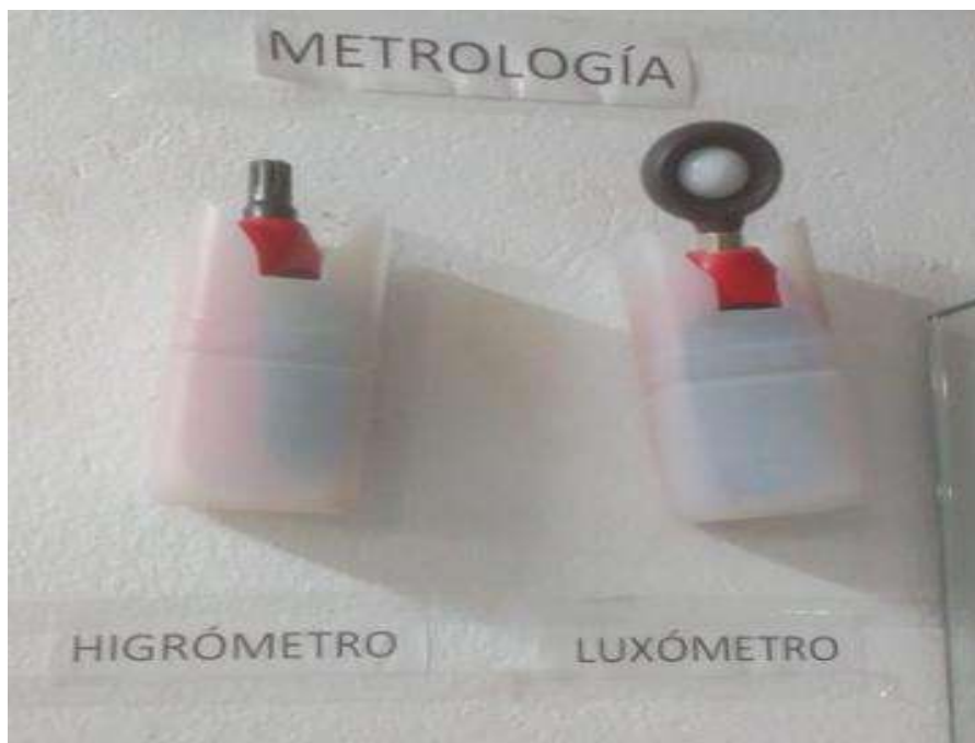
Foto: Higrómetro y Luxómetro instalados dentro del sótano de Archivo Central
